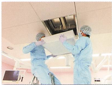
ヘパフィルター交換
